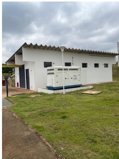
Figura TEC 7 – Gerador de energia na ETE Barroço.
